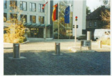
Versenkpoller für Straßensperrung
